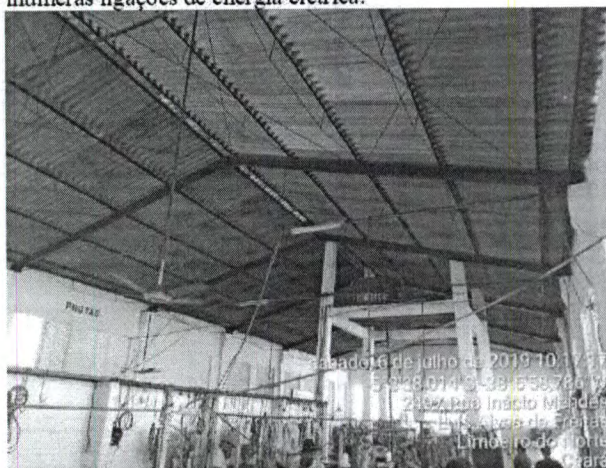
Foto 21 – Vista dos boxes de venda de carnes instalações elétricas em péssimas condições.
