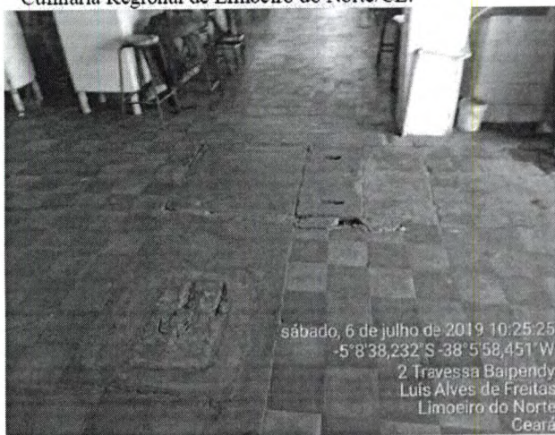
Foto 2 – Piso em ladrilhos hidráulicos apresentando elevado desgaste e caixas de passagem de esgoto.
