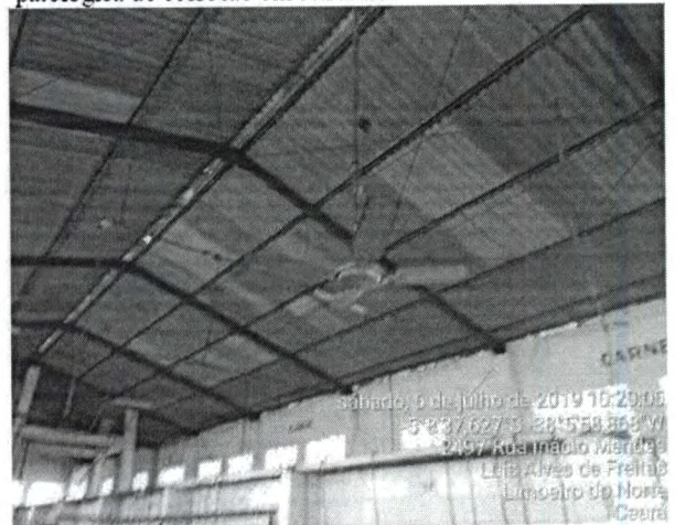
Foto 10 – Vista da estrutura da coberta e ventiladores danificados.
