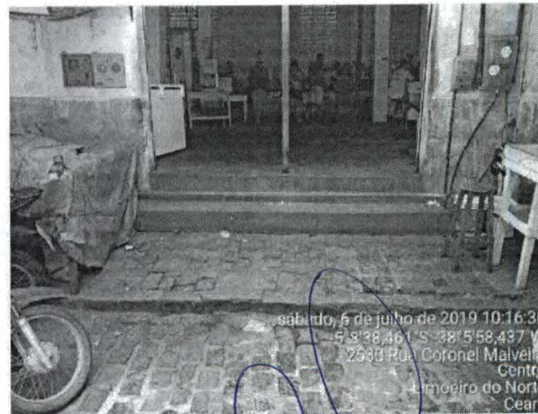
Foto 30 – Acesso lateral ao Mercado de Carnes e Peixes sem acessibilidade.
