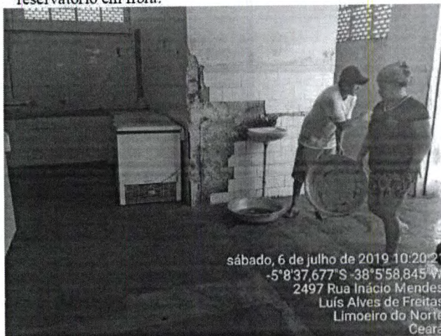
Foto 11 – Vista da área destinada a higiene dos feirantes sem condições básicas de higiene.
